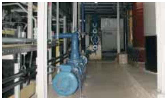
Filterpressenbeschickung in der Abwasseraufbereitung einer Galvanikfirma
