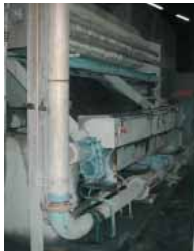
Dickstoffpumpe (GGB) direkt unter der Kammerfilterpresse
