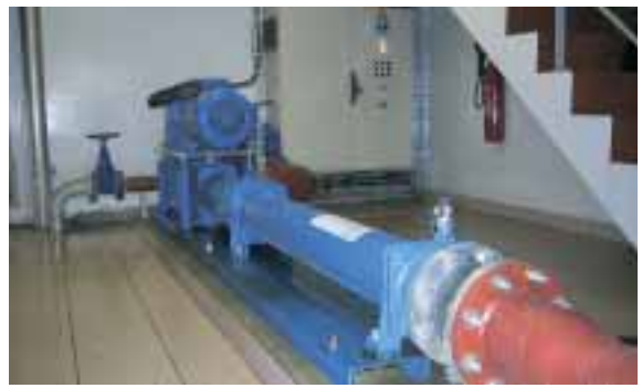
Pumpe mit Steuerschrank
